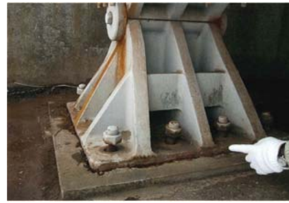
支承は沈み、アンカーボルトは細っている
