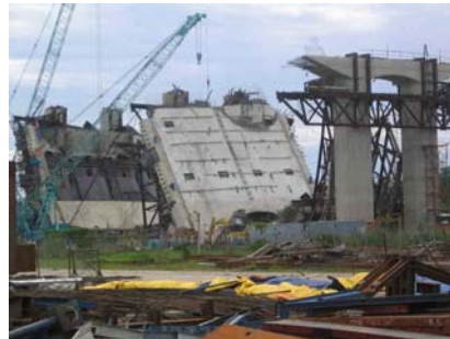
崩落したカントー橋の写真
